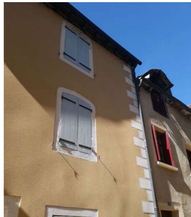
Enduit de façade avec décors peints, caractéristiques des techniques décoratives du XIXe siècle.
